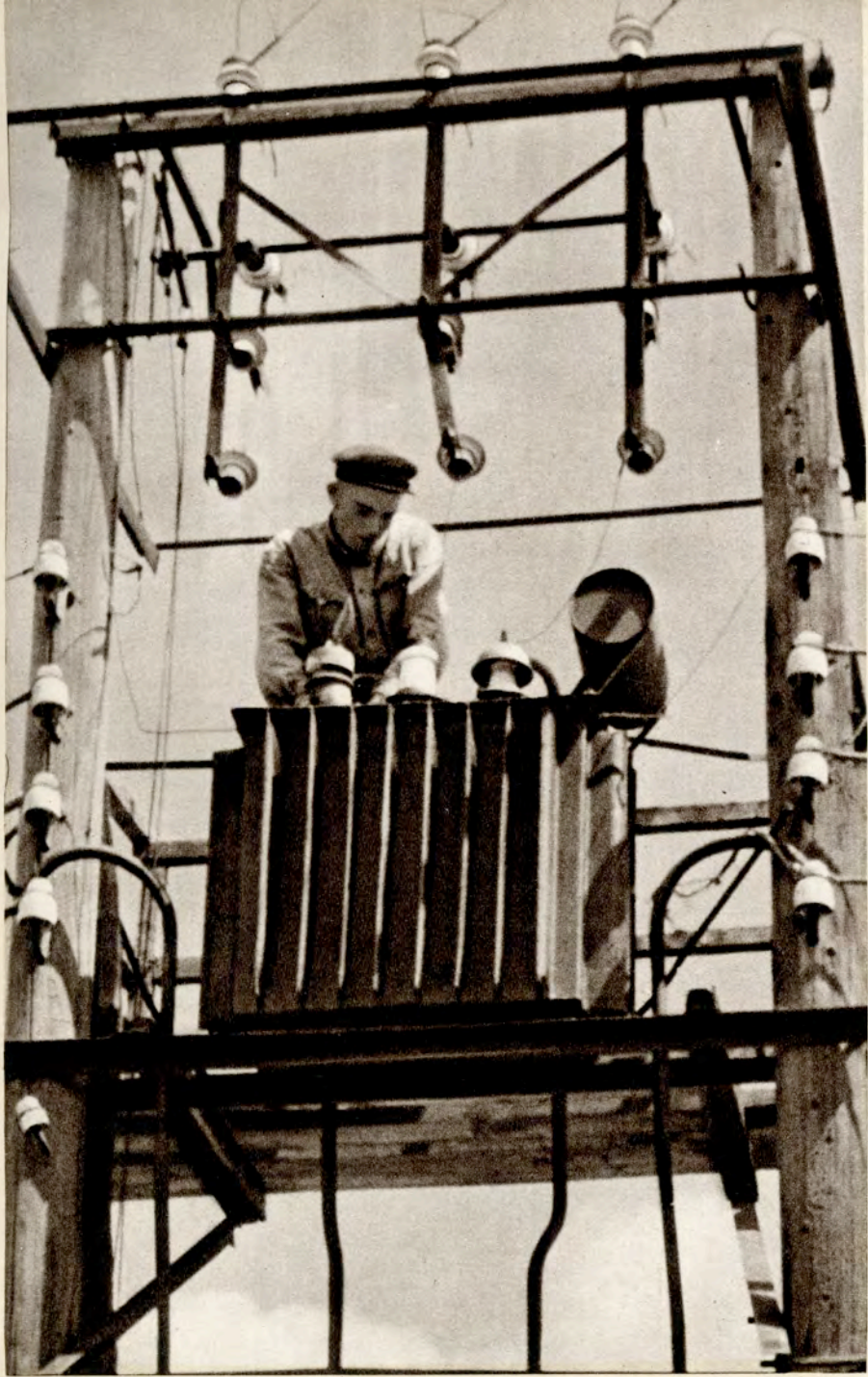
Колхоз полностью электрифицирован. Электричество проведено в дома колхозников, общественные здания, школы, клуб. На снимке: колхозный электромонтер Николай Зайчук за осмотром трансформатора.
